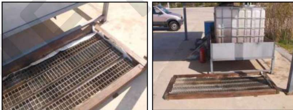
Στη συγκεκριμένη περίπτωση, στο δάπεδο έχει τοποθετηθεί και απορροφητικό ρολό για την απορρόφηση των αποστραγγισμένων που τυχόν θα τοποθετηθούν παραπλεύρως της Δεξαμενής χωρίς να εκκενωθούν.
